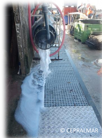
Décanteur (système canal)
